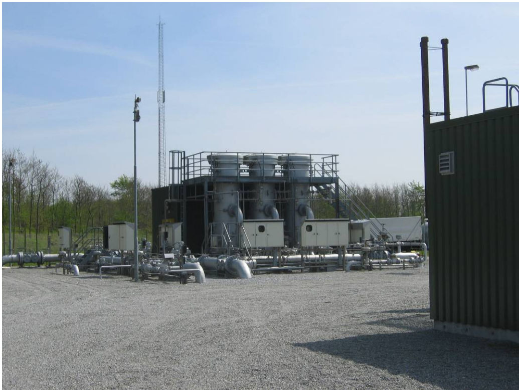
Figur 8.2 Filtre ved stationsmålebygning
